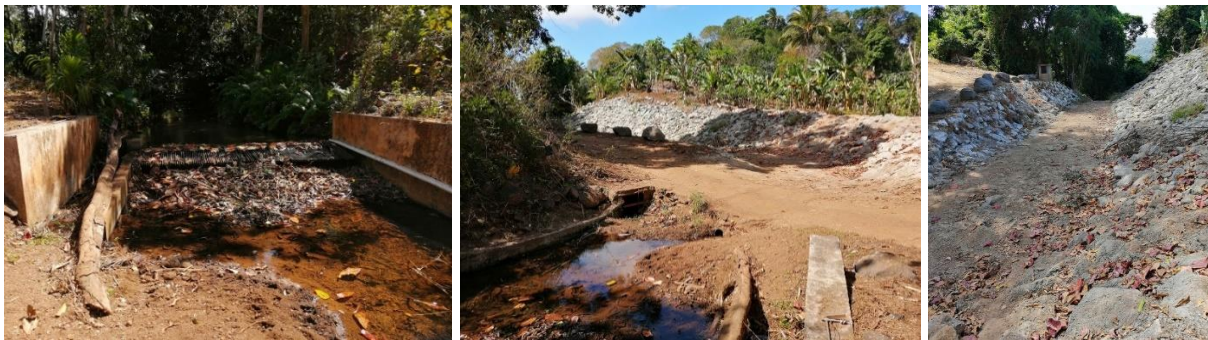
FIGURE 13 : PHOTO DES OUVRAGES RÉALISÉS DANS LE CADRE DES TRAVAUX D'URGENCE DE DÉVIATION DE LA MAPOUERA (FRMR01)
